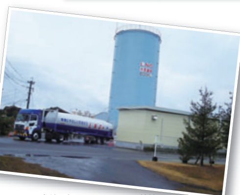
宮崎工場 LNG サテライト基地
