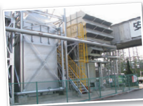
名古屋工場 コージェネレーションシステム
